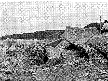
津波で破壊された 大成町の堤防
